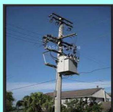
戶外電氣設備
